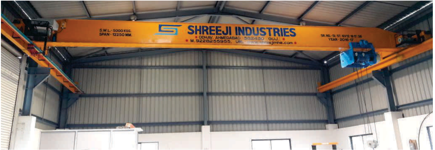
SI - 173 EOT Crane Capacity: 1 Ton / 20 Ton
